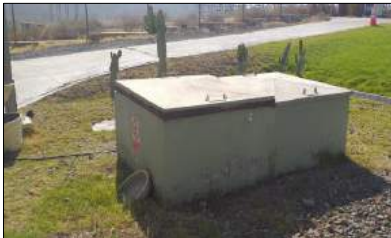
Figura 3.3.2.1- 3. Reservorio de agua para servicios
